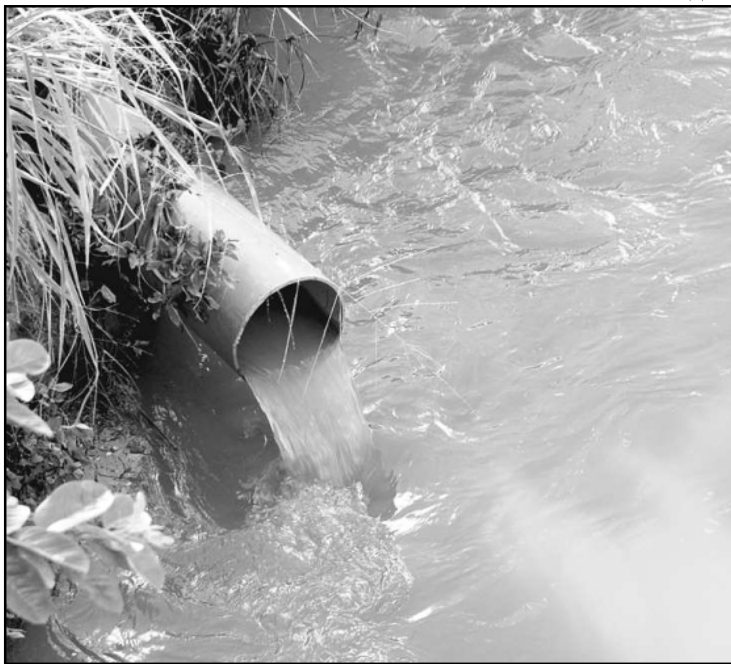
Esgoto do Bairro Tijuca, em Contagem, é despejado sem qualquer tratamento no Córrego Água Funda, que desemboca na Lagoa da Pampulha
